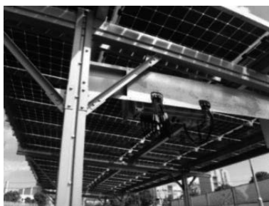
図表 2-2 駐車場屋根置き太陽光発電設備
